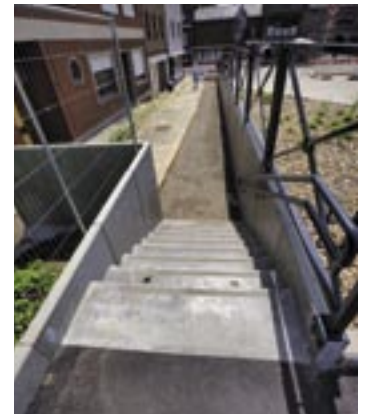
Die gerade erst fertiggestellte Treppe soll wieder beseitigt werden!
